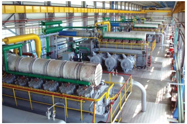
Фото 2. Газомотокомпрессорный цех с установками МКС12 производства АО «РУМО»
